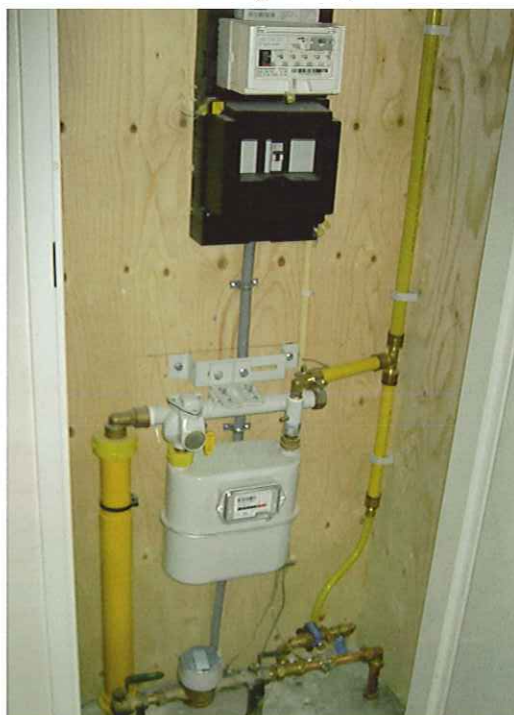
Meterkasten toegankelijk houden en niet voor opslag gebruiken.
